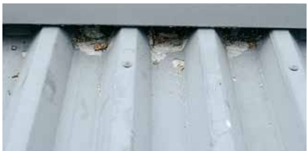
Katon koloihin kertyy herkästi orgaanisia epäpuhtauksia, jotka sitovat itseensä kosteutta. Näissä kohdin pinnoite irtoaa herkästi ja ruostuminen pääsee alulle.
